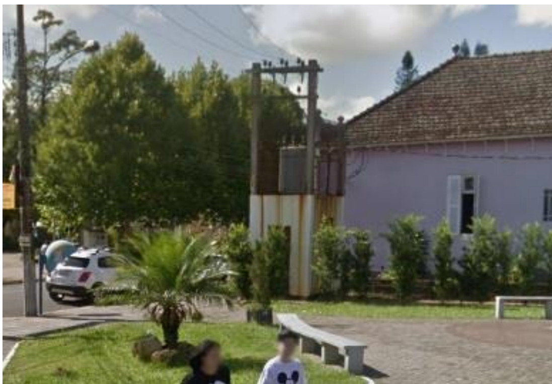
Foto 2 – Subestação existente fora das normas regulamentadoras.
