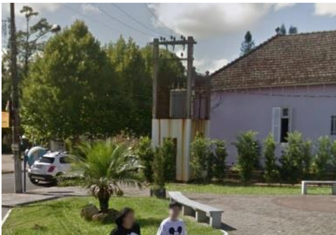
Foto 2 – Subestação existente fora das normas regulamentadoras.
