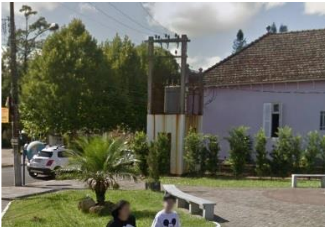
Foto 2 – Subestação existente fora das normas regulamentadoras.
